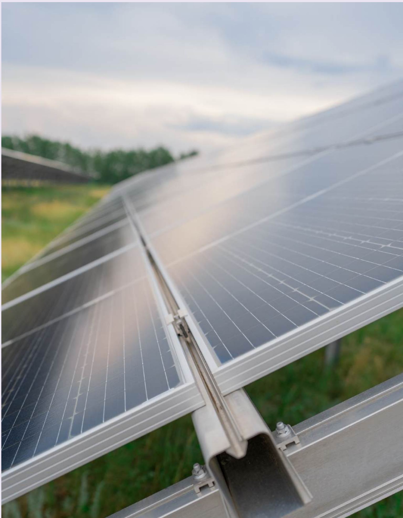
Painéis fotovoltaicos: demanda cresce no Brasil
